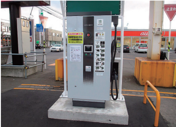
電気自動車用急速充電器です。
