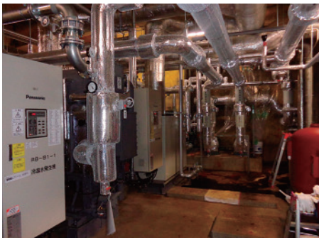
新しい冷暖房用の冷温水発生機と配管です。
